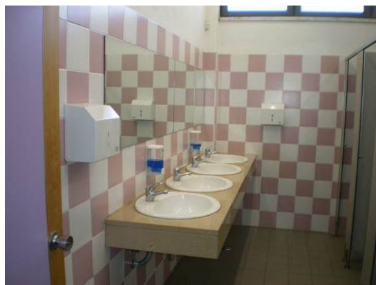
Instalações sanitárias femininas
